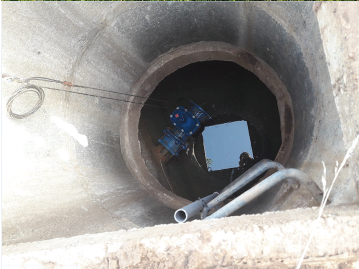
Intérieur du regard : canalisation avec vanne manuelle d'alimentation du réservoir.
